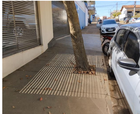
Figura 02: Rachadura causada pelas raízes da planta.
